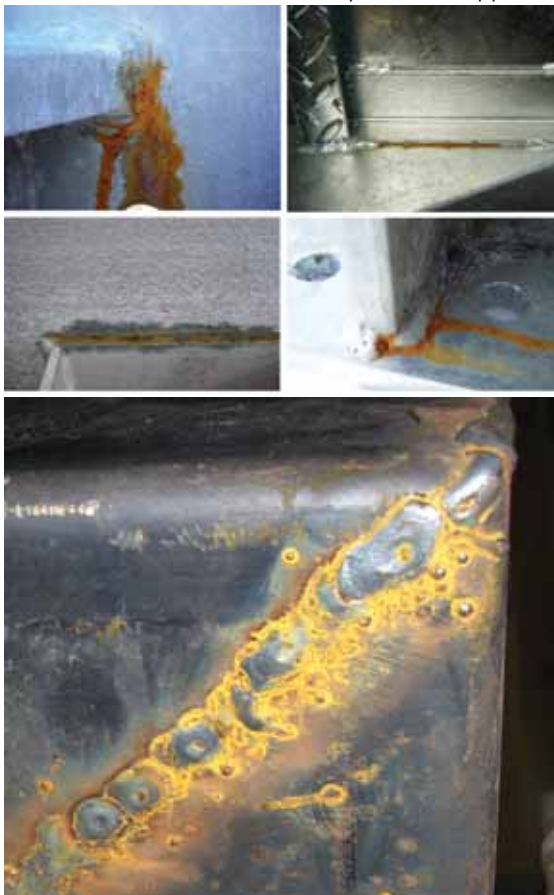
Figura 30 Difetti causati per imperfezione della saldatura
