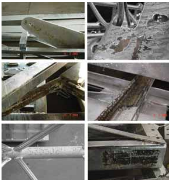
Figura 39 Difetti di rivestimento dovuti alla presenza di impurità non idrosolubili sulla superficie dell'acciaio
