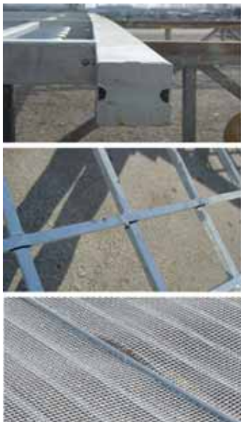
Figura 38 Deformazioni avvenute in fase di zincatura
