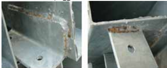
Figura 28 Difetti causati dalla mancata pulizia della saldatura
